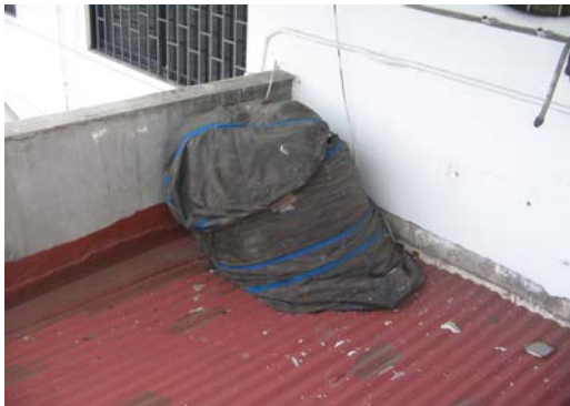
Bolsa abandonada en el techo de la bodega
