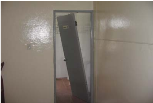
Áreas de la empresa en mal estado.
