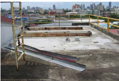
Este es un área de la empresa que ya no se utiliza, pero que ha sido abandonada y la tienen en este mal estado.
